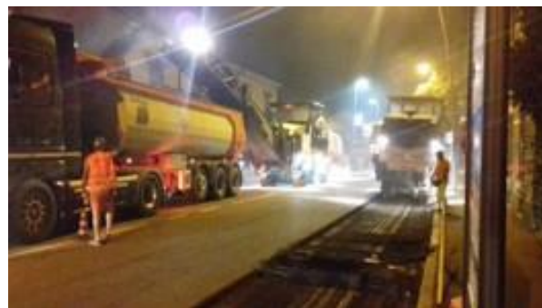
Figura 1 – Stesura della nuova pavimentazione su Viale della Libertà (foto: staff LIFE MONZA)
