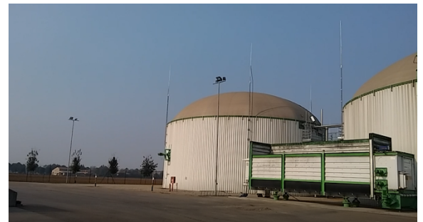
Figura 2: Uno degli impianti di biogas per la valorizzazione e buona gestione degli effluenti di allevamento (foto: staff LIFE DOP)
