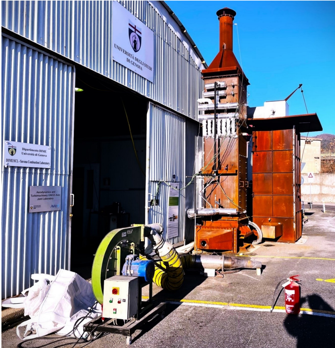
Figura 2. Il mock-up installato presso il Campus di Savona dell'Università di Genova.
