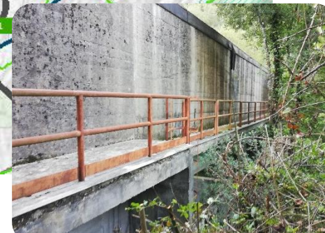
Attraversamento Fosso Rasciano (pontetubo)
